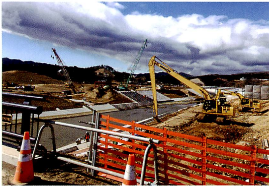
大規模な復興工事の様子（南三陸町志津川地区）。市街地・国道がかさ上げされ、河川堤防が築かれた。
